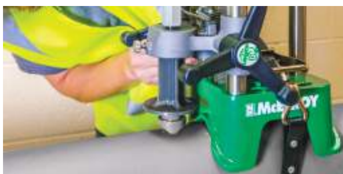
Сварщик приваривает отвод на главной трубе инструментом для приварки седловых отводов Hornet™
