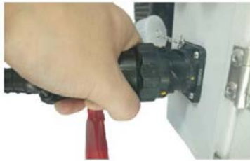
Соединение кабеля с электрической коробкой
